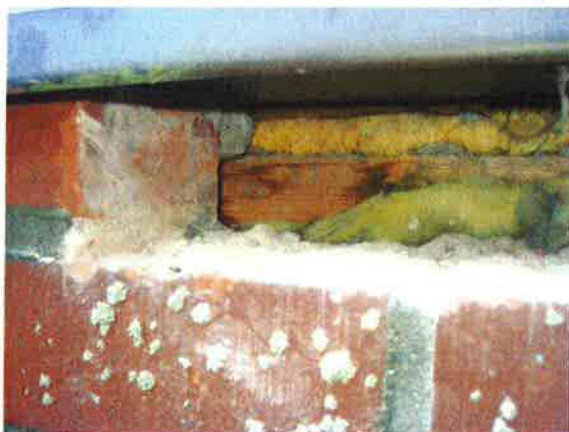
Kuva 5. Ulkoseinässä ei tuuletusrakoa.
