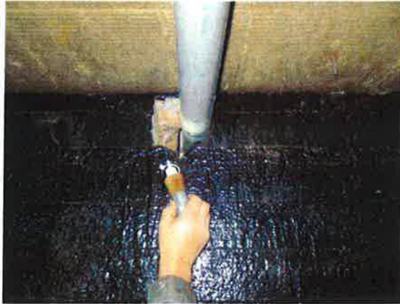
Kuvat 25 ja 26. Epätiivittä läpivientejä ryömintätalasta.
