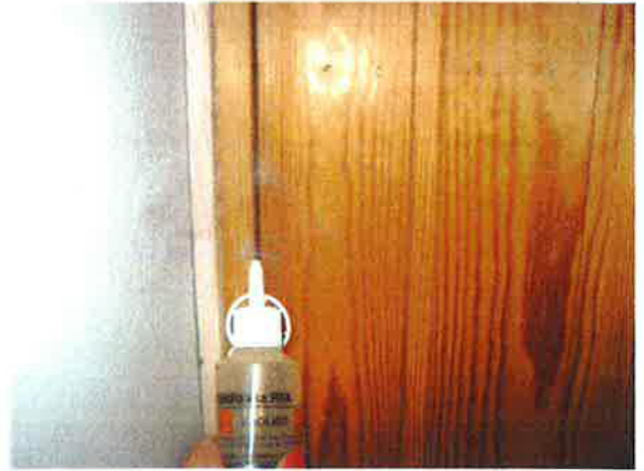
Kuva 38. Hätäpoistumistien ovi ei ole tiivis.
