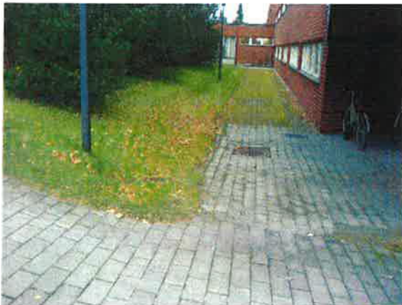
Kuva 17. Maanpinta viettää rakennukseen päin.
